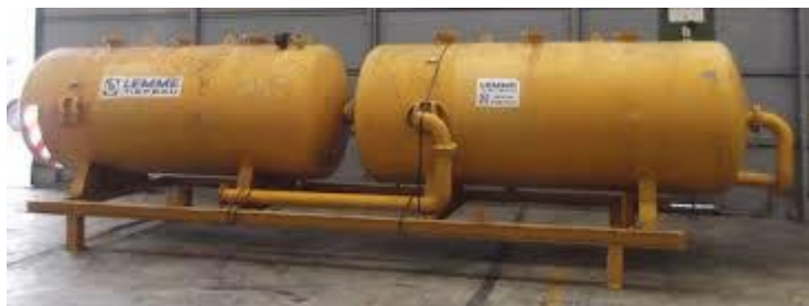
Horizontalni spremnici stlačenog zraka
