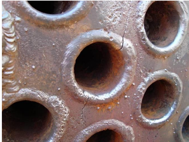
Pukotina na mostiću i zavaru
